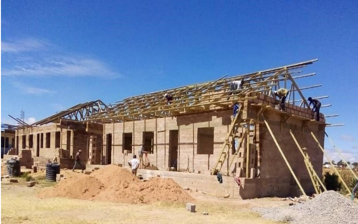
Mwonekano wa vyumba 04 vya madarasa shule ya Msingi Mnung'una vikiwa katika hatua ya uwekaji kenchi.
