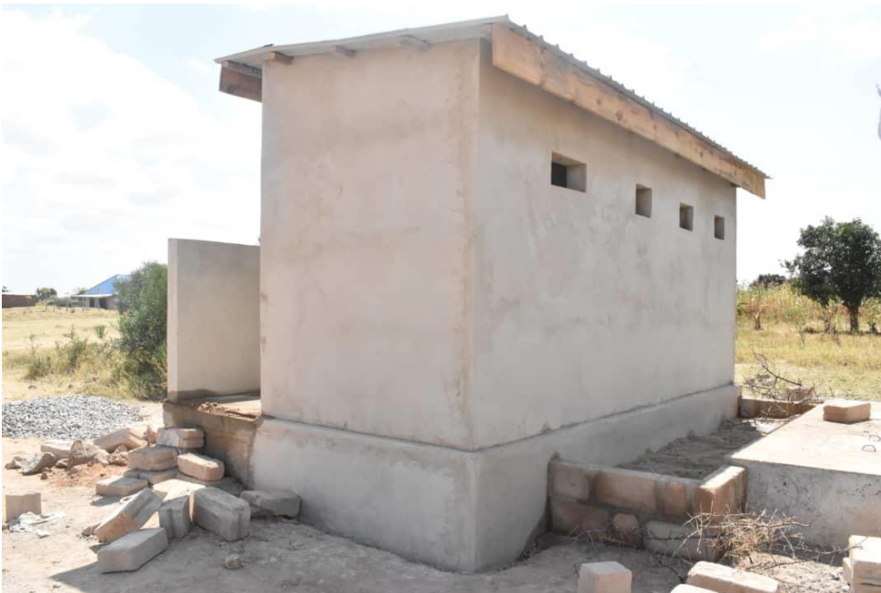
Ujenzi wa matundu 04 ya vyoo shule ya msingi Mwembemoja ukiendelea na hatua ya ukamilishaji.
