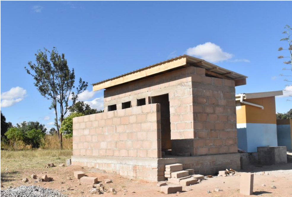
Ujenzi wa matundu 04 ya vyoo shule ya msingi Mwembemoja ukiendelea na hatu ya ukamilishaji
